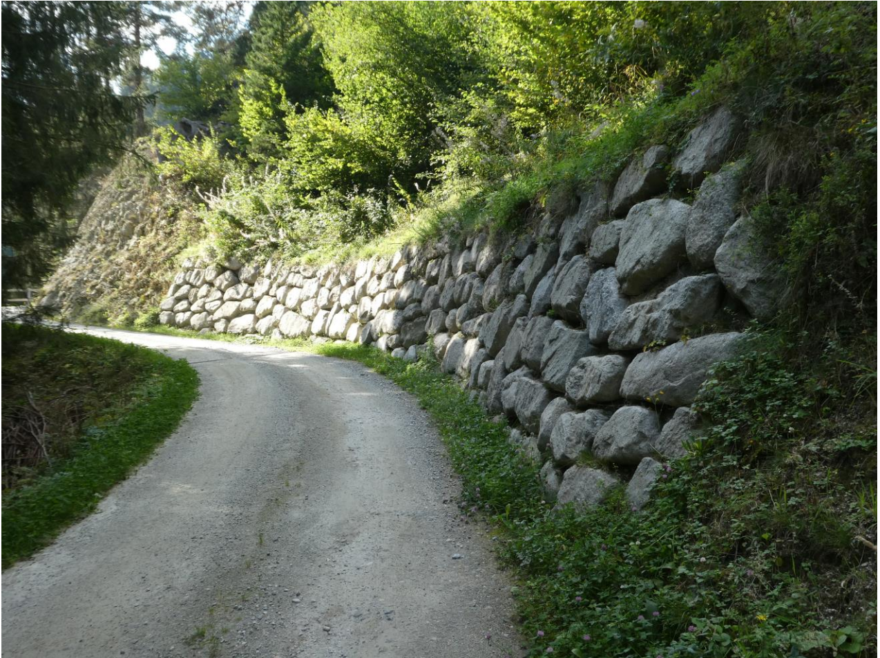
Mirs da blocca en betun, (fotografia exempel via d'uaul a Munt, Trun, fotografau treis onns suenter la construcziun)
