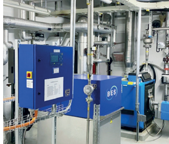
Centrala d'energia e scaldament
